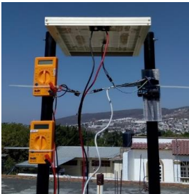
Fig. 6. Instalación del panel solar al aire libre.
